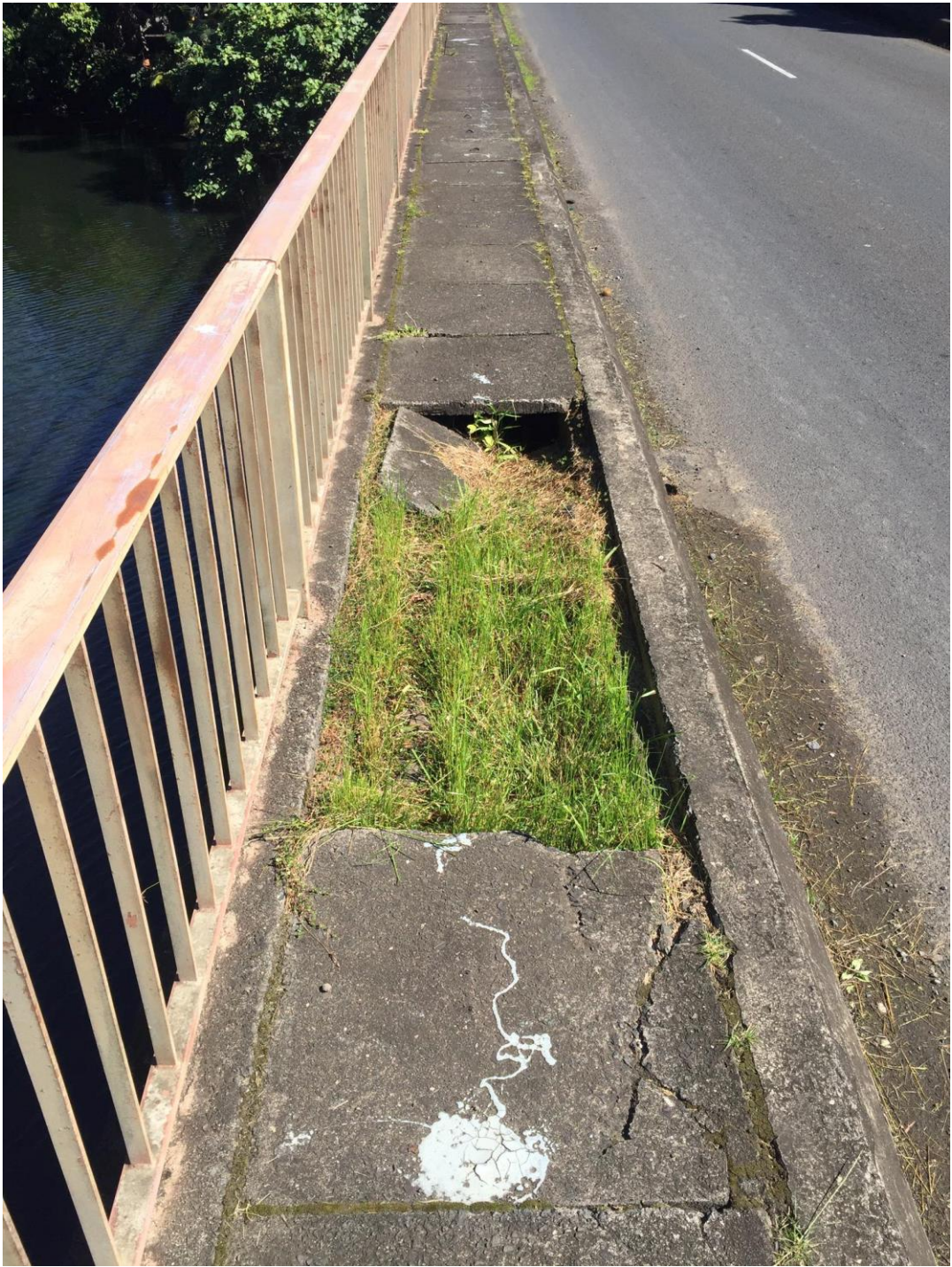
5) Trottoir défoncé du 2 e pont de Papenoo
